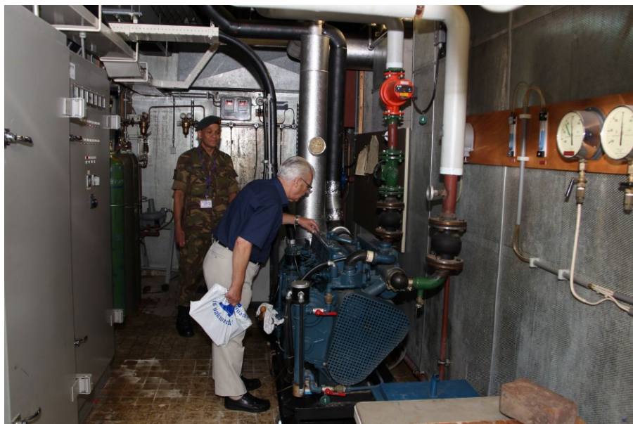
De auteur, Ikol b.d. Rijntalder, inspecteert na ruim 35 jaar het dieselaggregaat in de volledig nog intact zijnde technische ruimte. Op de achtergrond majoor G.L. Ma-Ajong van het basecommando. (foto: kap b.d. A.J.J. Buitendam, juli 2016)
