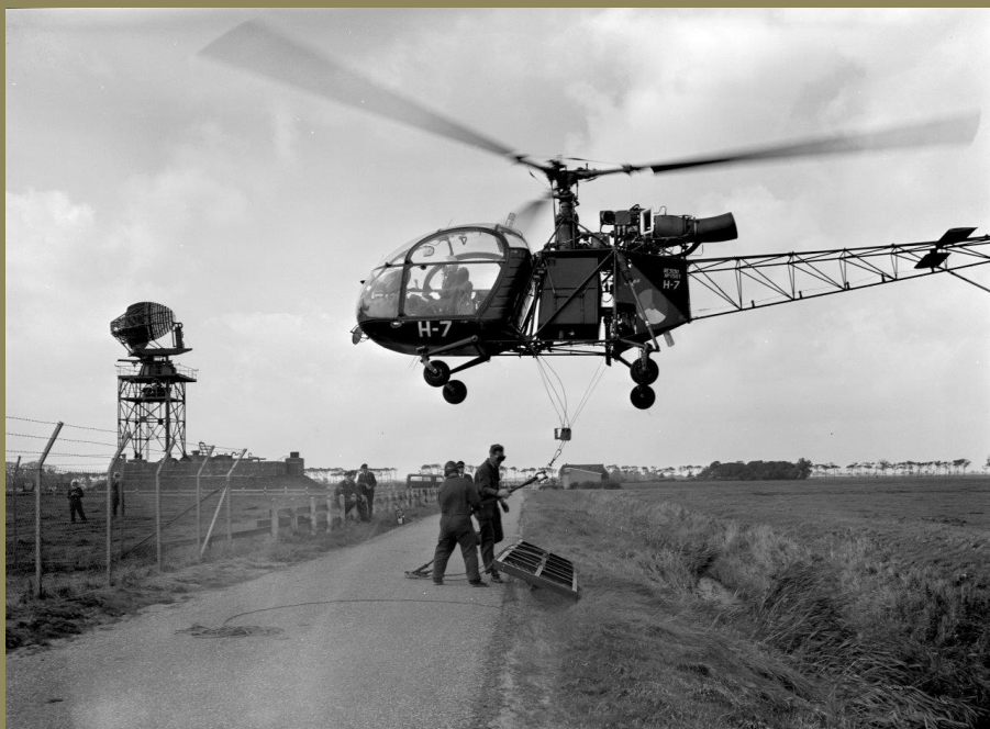
Holwierde 1962, Navigatiestation Groningen (NSG). Met behulp van een Alouette II wordt de antenne van de nieuwe Lange Afstands Radar (LAR) type ER 438 geplaatst. Na de sluiting en de ontmanteling van het NSG in 1964 werd de ER 438 radarinstallatie in 1966 overgebracht naar de 2e Groep Geleide Wapens in Schöppingen (BRD). Foto: NIMH]
